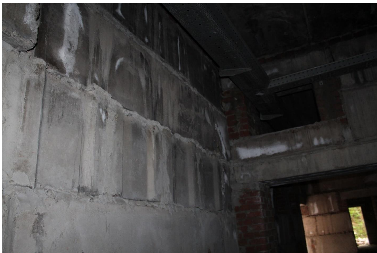
Фото 8, 9. Стена в осях «6-7/Т-Я»; «6-27/Я»; «26-27/Т-Я» (верхнее фото – со стороны автостоянки, нижнее – со стороны объекта незавершённого строительством)
